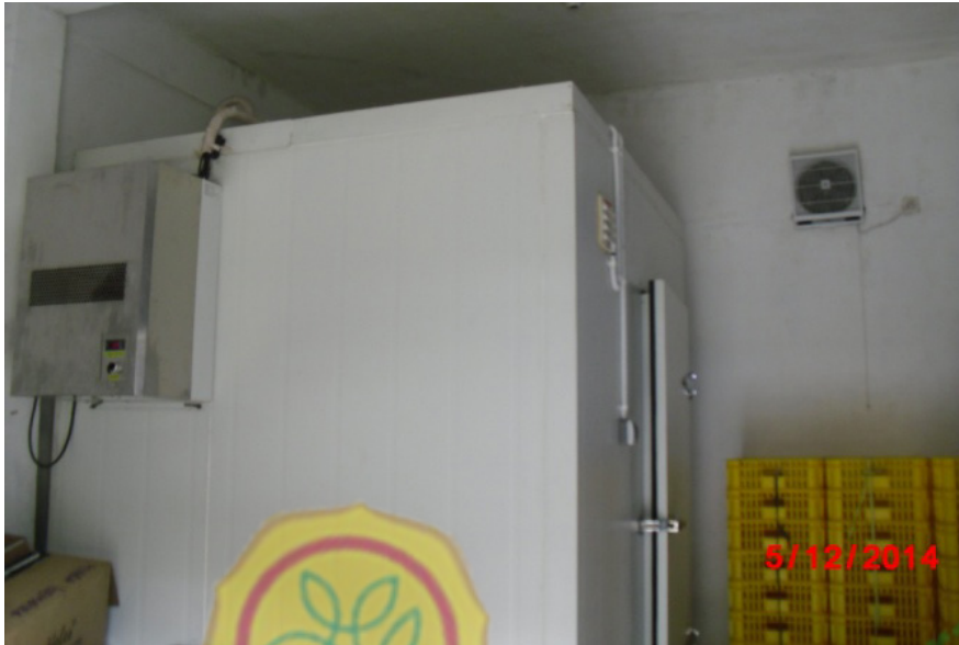
Ruang berpendingin untuk penyimpanan cabai
